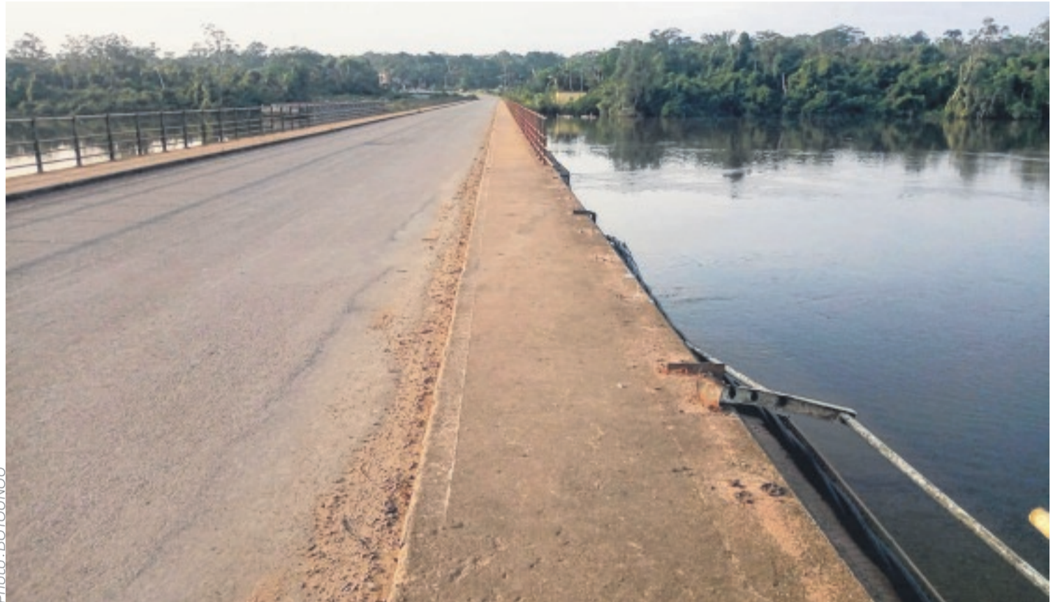
Une vue des garde-fous endommagés après la chute du camion.
